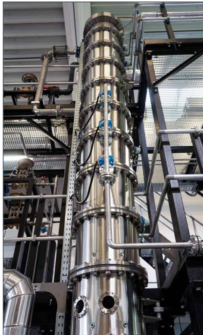
Procédé de distillation: colonne de rectification
