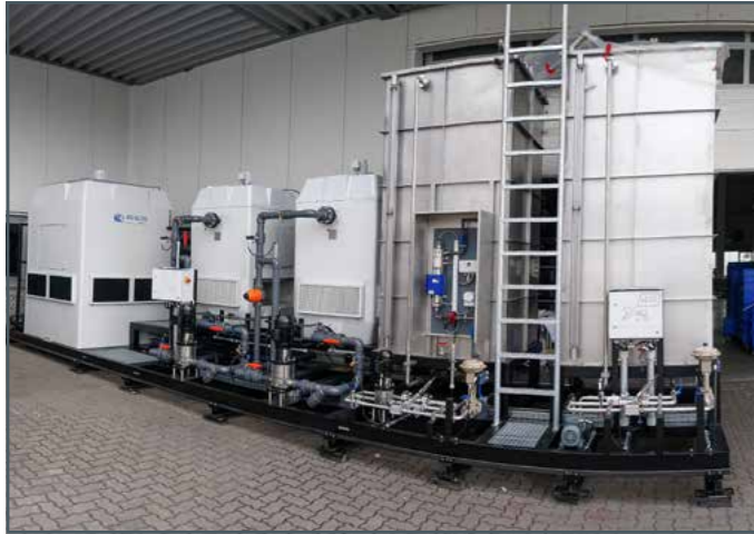
Tours de refroidissement humides et réservoirs de stockage pour l'eau de processus et l'éthylène glycol à l'extérieur
