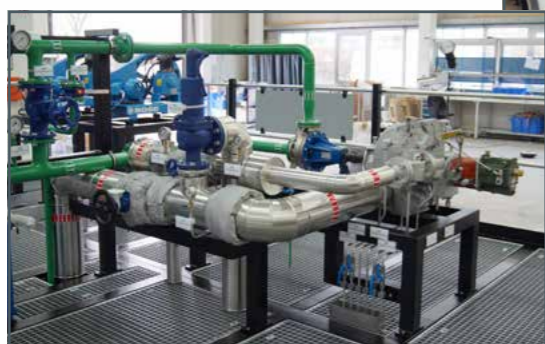
Station de pompage auxiliaire alimentée en vapeur
